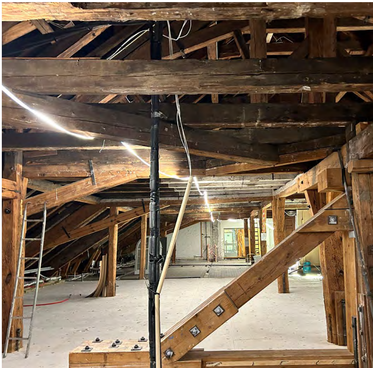
Tagrummet, der står tilbage efter branden. Nyindretning kan understrege enkeltheden på etagen – og de nye funktioner vælges, så de passer til rumlige karaktertræk. Foto: Merete Lind Mikkelsen
