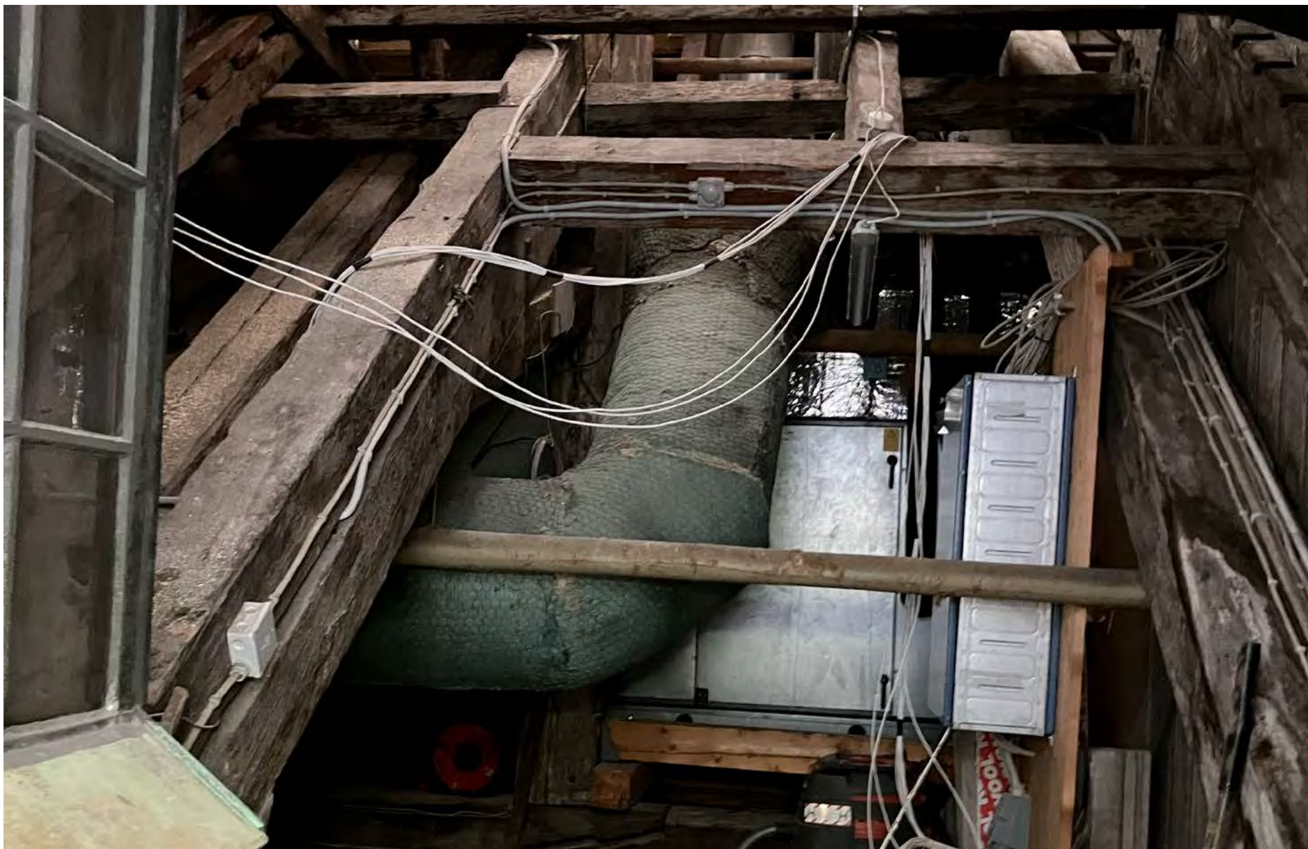
De gamle ventilationsanlæg var snoet ind i den gamle konstruktion alt efter hvad der var muligt. Mange installatører har været vanskelige at komme til efterfølgende
