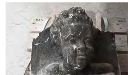
Hel figur, næsten intakt. Figuren er sodskadet efter længerevarende brand i vindue. Figuren forsøges sodafrensnes. Figuren bevares hvis sten ikke er skadet af for høj temperatur
