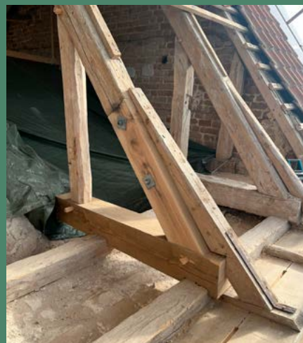
Dårlige spær- eller bjælkeender kan fx repareres ved udlusning og sammenboltning.
