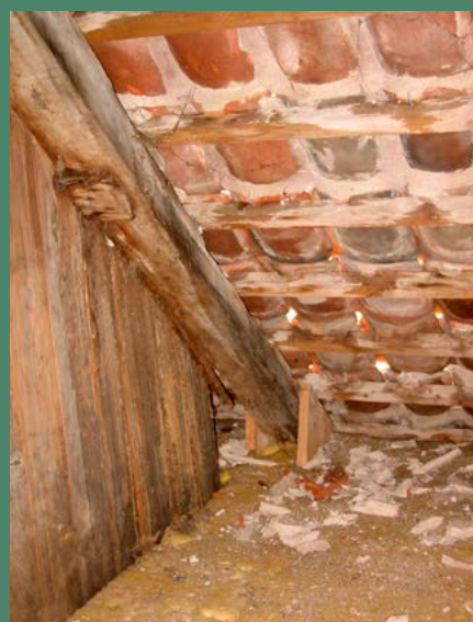
Understrygningen er faldet ned, og taget er ikke længere tæt.
