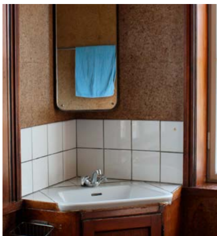
Vægbeklædning med korkfliser i Bedre Byggeskik-hus fra 1929.
