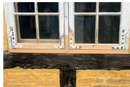
Nedbrudte partier af fx vindueskarme og -rammer kan typisk klares med reparationer i stedet for en total udskiftning.
