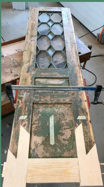
En gammel ret ødelagt og skadet hoveddør kan repareres med udlusninger af det skadede træ. Det er ofte den nederste del af dørbladet, der er skadet.
