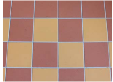
Badeværelsets gulvbelægning er fornyet og lagt i skaktern af okker- og terrakottafarvede klinker.
