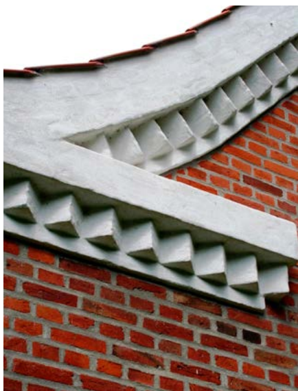
Savsnitsgesimserne blev brugt op i 1930'erne – her overkalket sammen med rødt murværk.
