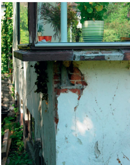
Et utæt, indbygget nedløbsrør har givet fugtskader på murværket. Sådanne skader kan være meget dyre at udbedre, hvis de ikke opdages i tide.
