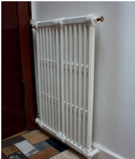
En fin oprindelig radiator i støbejern.
