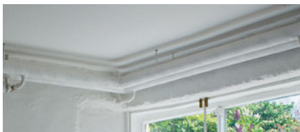
Kælderens rørinstallationer er isoleret på traditionel vis med mineraluld og omviklet med lærred, der er malet. En dyrere løsning end moderne plastklædte isoleringskapper, men til gengæld langt smukkere.
