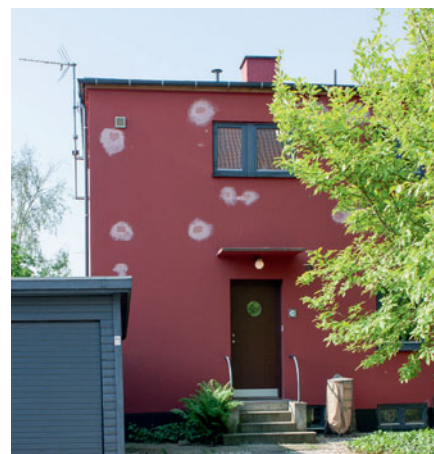
Pas på med hulmursisolering af huse med pudsede og malede facader – ydermurens fugtbalance vil ændres, og det kan føre til fugtphobning på facaden.
